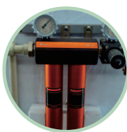
压缩空气过滤器
